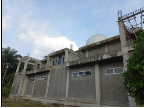
Kondisi eksisting masjid dilihat dari arah Barat, dimana terlihat struktur masjid yang belum ada kulit bangunannya.
