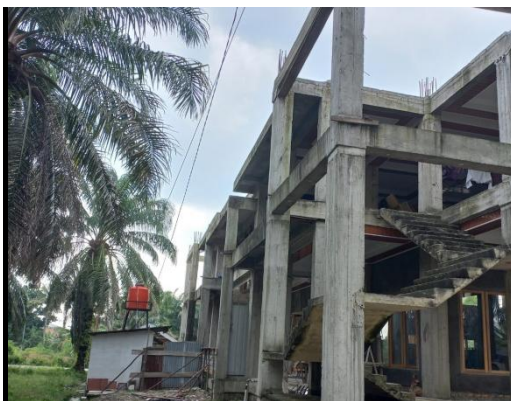
Kondisi eksisting masjid dilihat dari arah Barat , dimana terlihat struktur masjid yang belum ada kulit bangunanannya.
