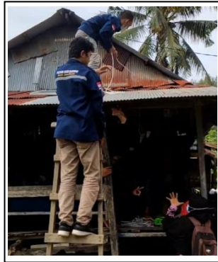
Gambar 5. Penempatan panel surya 50 wp di atap rumah warga
